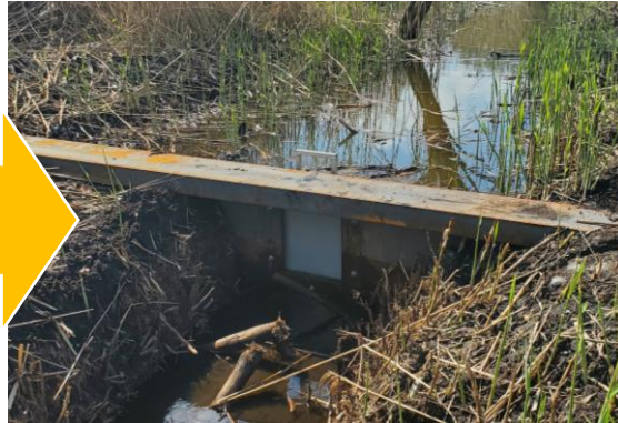
Graben mit Stauwehr inklusive Schieber
